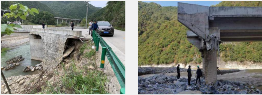
图 5-10 勘察水毁道路现场
