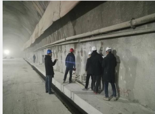
图 5-2 隧道校验检查
