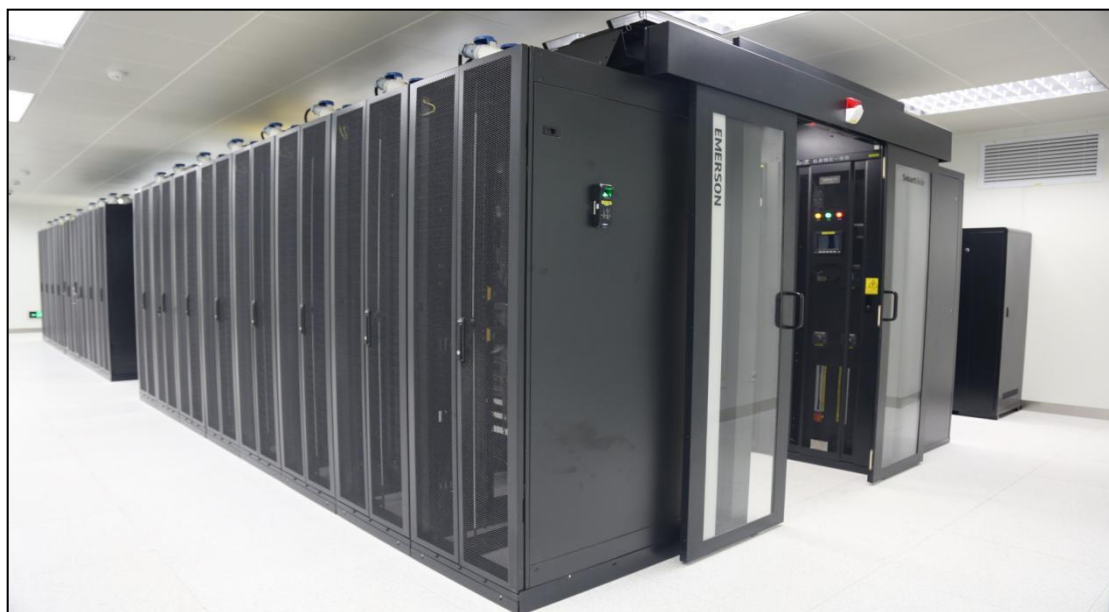
图 1 学校网络中心机房
